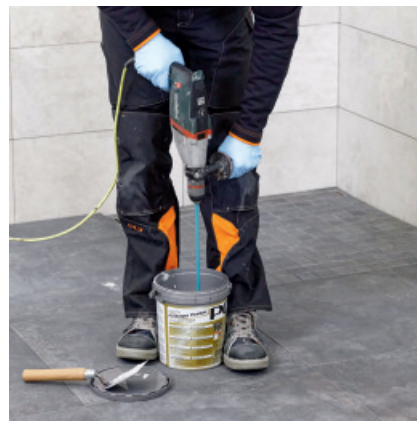
Mélanger 3 minutes. Transvaser le matériau mélangé dans un récipient et malaxer à nouveau de façon à obtenir une teinte homogène.
